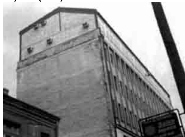
Sl.13 – Primer substandardne nadgradnje.
